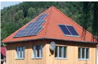
Solarthermie-Flachkollektoren an einem steilen Dach
