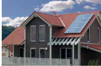
Solarthermie-Flachkollektoren quer angebracht
