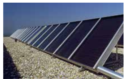
Solarthermie-Flachkollektoren im Freiland
